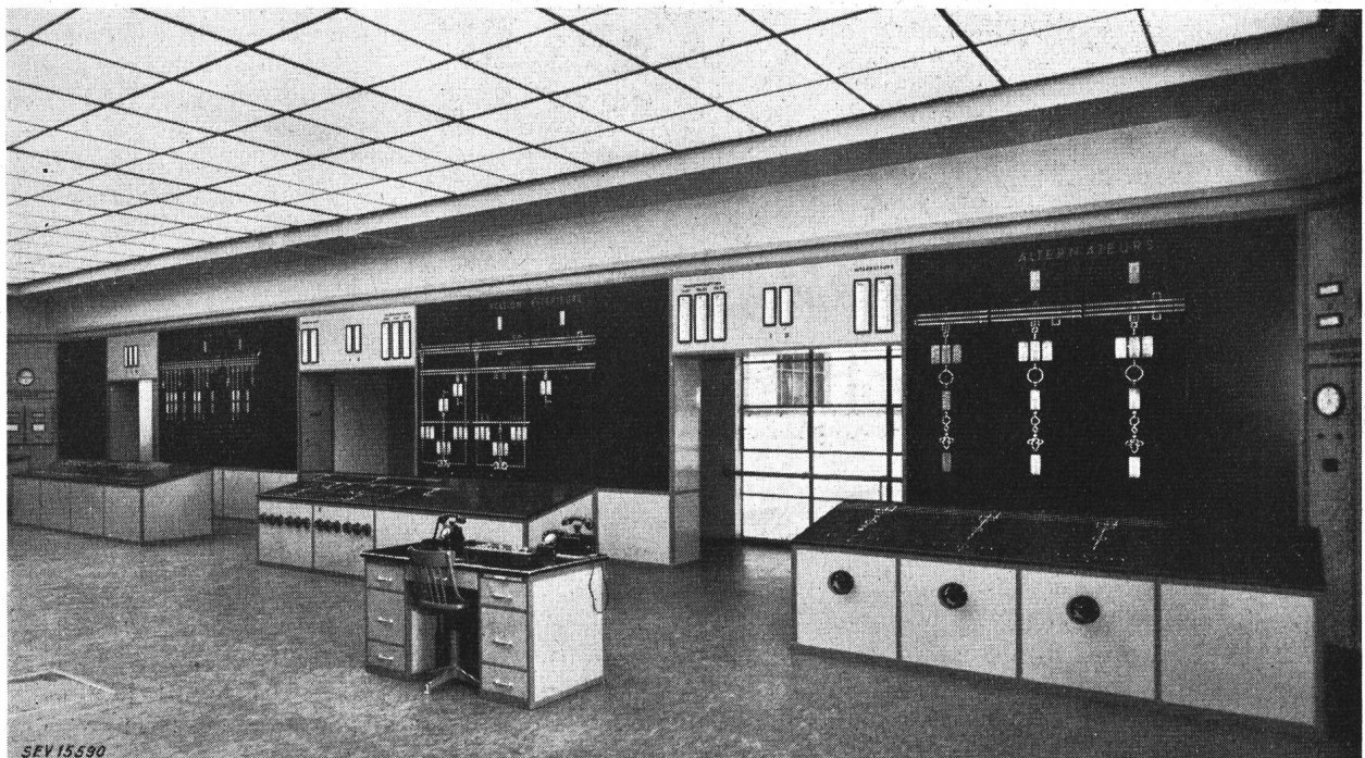
Fig. 7 Kommandoraum mit Schattenpfeil- und Lichtzeiger-Instrumenten (Aufnahme: Service de l'électricité de Genève)
