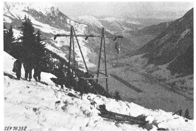
Fig. 11 Gotthardleitung Abspannmast aus Holz an der Unterbruchsstelle bei Mast Nr. 49 oberhalb Piotta
