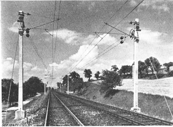
Fig. 3 Fahrleitung der Einheitsbauart der ÖBB Strecke Linz—Amstetten
