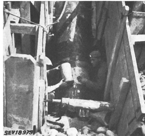
Fig. 3 Isolation d'un joint soudé de la nouvelle conduite d'eau de la Hard à Bâle (P. Pfirter, Pratteln)
