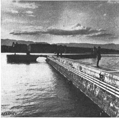
Fig. 5 Câbles électriques le long de la jetée
