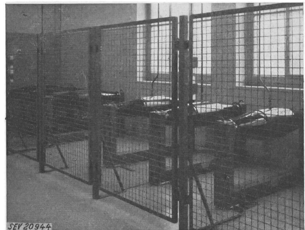
Fig. 14 Sechs Spannungswandler, Pol-Erde, 60 kV
