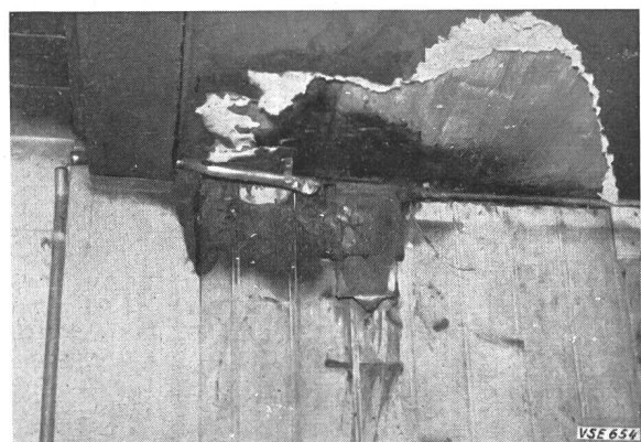
Fig. 5 Brandschaden beim Abonnent Schoch (Photo TD St. Gallen)
