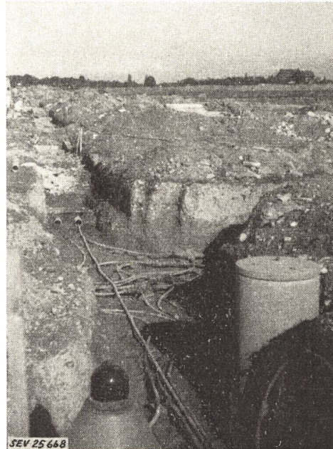
Fig. 6 Prolongation de la piste, côté N-E Terrassement pour câbles; à droite, un puits en ciment pour feu de piste
