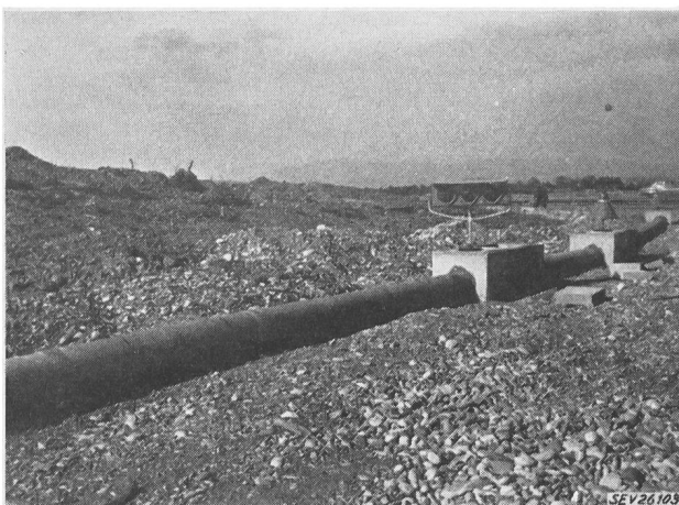
Fig. 3 Zementrohrleitung mit Lampenkasten Rechts eine Pistensperrleuchte mit einer grünen und zwei roten Lampen
