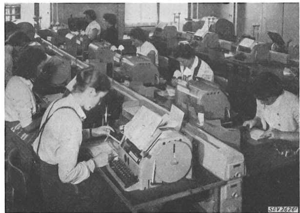
Fig. 13 Vue partielle de la salle des appareils de l'office télégraphique de Berne
