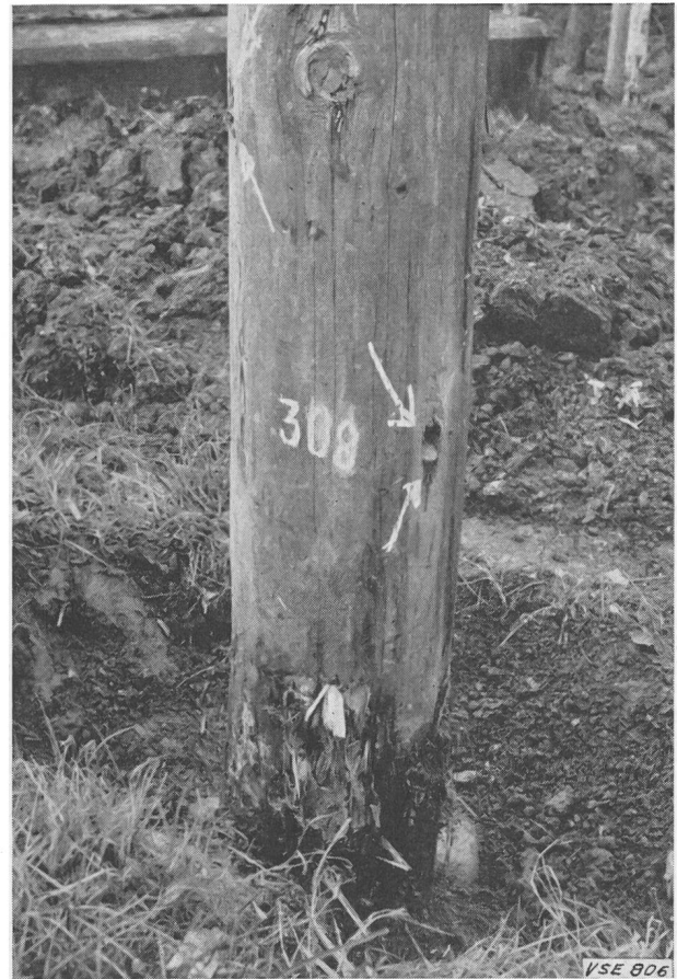
Fig. 5 Mit einem öligen Schutzmittel mittels Bohrlochtränkung nachgepflegte Stange, von Pilzen angegriffen
