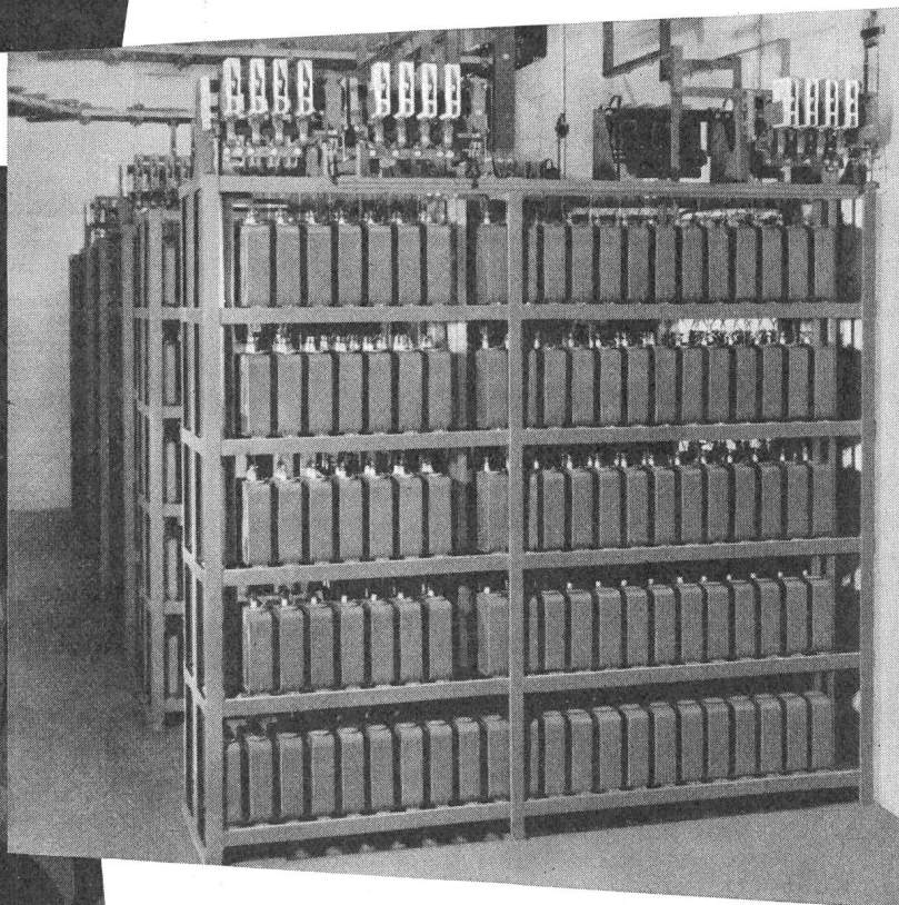
Teilansicht einer vollautomatischen Kondensatorenanlage in einer Grossgiesserei
