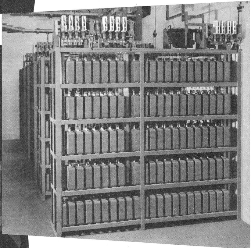
Teilansicht einer vollautomatischen Kondensatorenanlage in einer Grossgließerei
