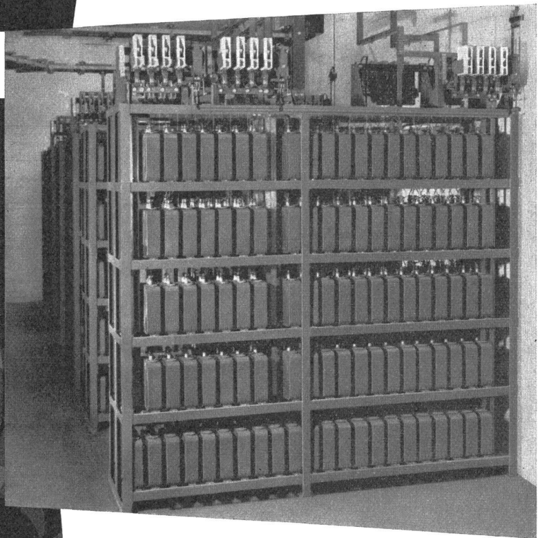
Teilansicht einer vollautomatischen Kondensatorenanlage in einer Grossgiesserei
