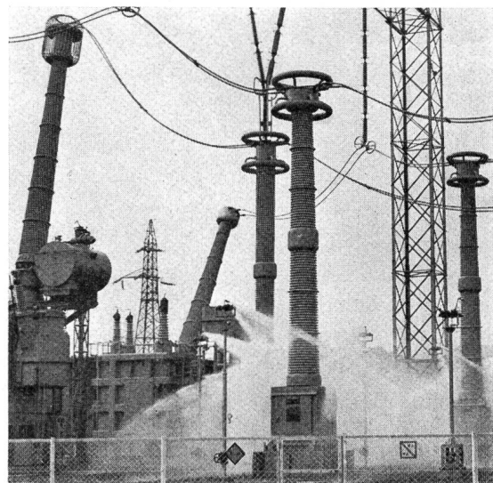
Fig. 13 500-kV-Einspeisung mit Absprüheinrichtung im High Voltage Power Laboratory in Takeyama Isolatorenlänge 8 m
