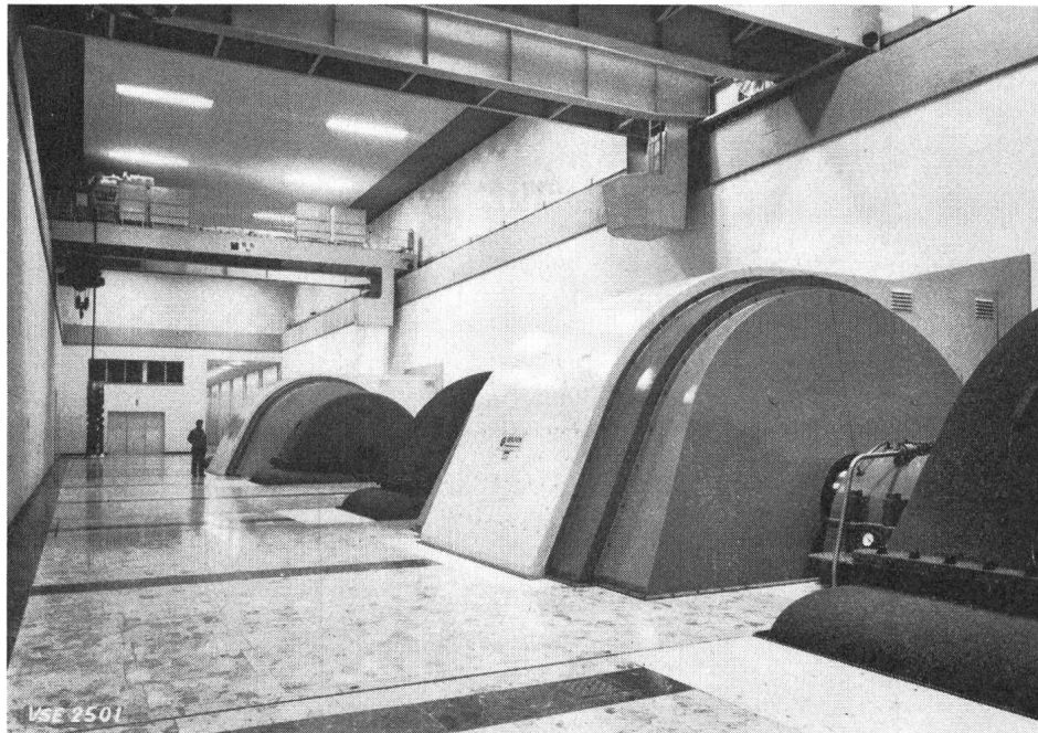
Fig. 2 Die Kavernenzentrale Stalden
