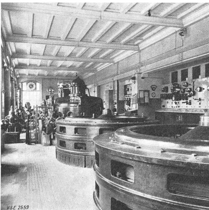
Fig. 3a Maschinensaal Aufnahme 1915
