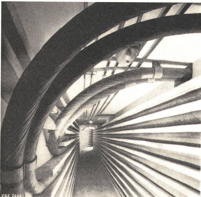
Fig. 8 Kabelanordnung in einem begehbaren Kabelkanal
