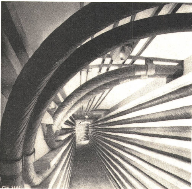
Fig. 8 Kabelanordnung in einem begehbaren Kabelkanal
