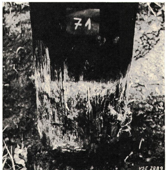
Fig. 1 Leitungsstange mit Kupfersulfat imprägniert und in der Bodenzone durch Poria vaillantii vermorscht. Vorn und rechts an der Stange für diesen Pilz charakteristische weisse Mycelstränge.
