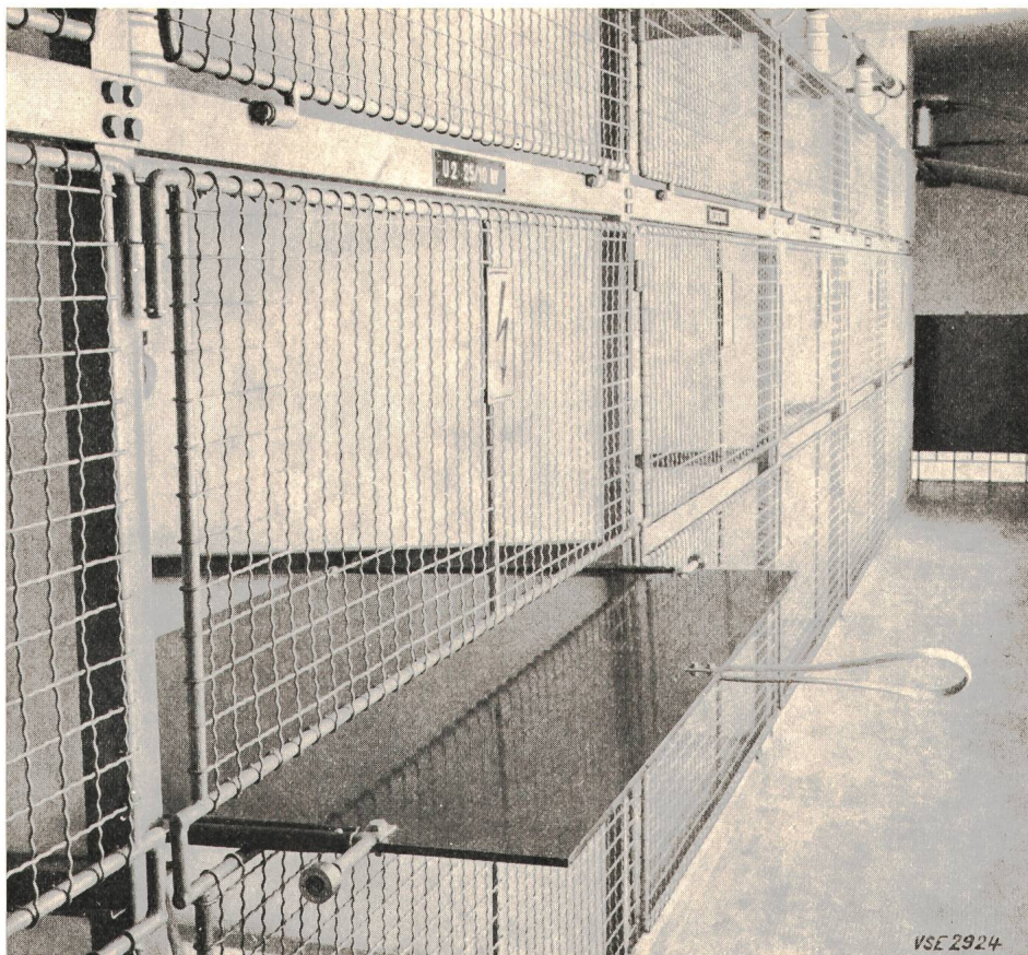
Fig. 1 Einschub-Schutzplatte (mit Bedienungsschleife) in einer 25 kV-Schaltanlage (OKA) Ein gefahrloses Einschieben der Platte bereits vor dem Öffnen des Gitters wird durch einen Schlitz in letzterem erreicht.
