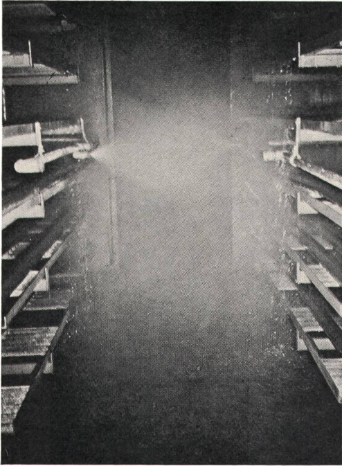
Fig. 14 Sprühflutanlage in einem Kabelkanal Installation déluge dans un caniveau de câbles
