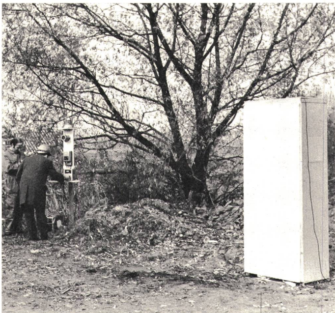
Schaltschrank mit Rauchmelder und Alarmanrichtung. Die Anzeigeeinstrumente sind auf der linken Bildhälfte sichtbar Armoire de commande avec détecteur à fumée et système d'alarme. Le tableau avec des instruments de mesure est visible à gauche
