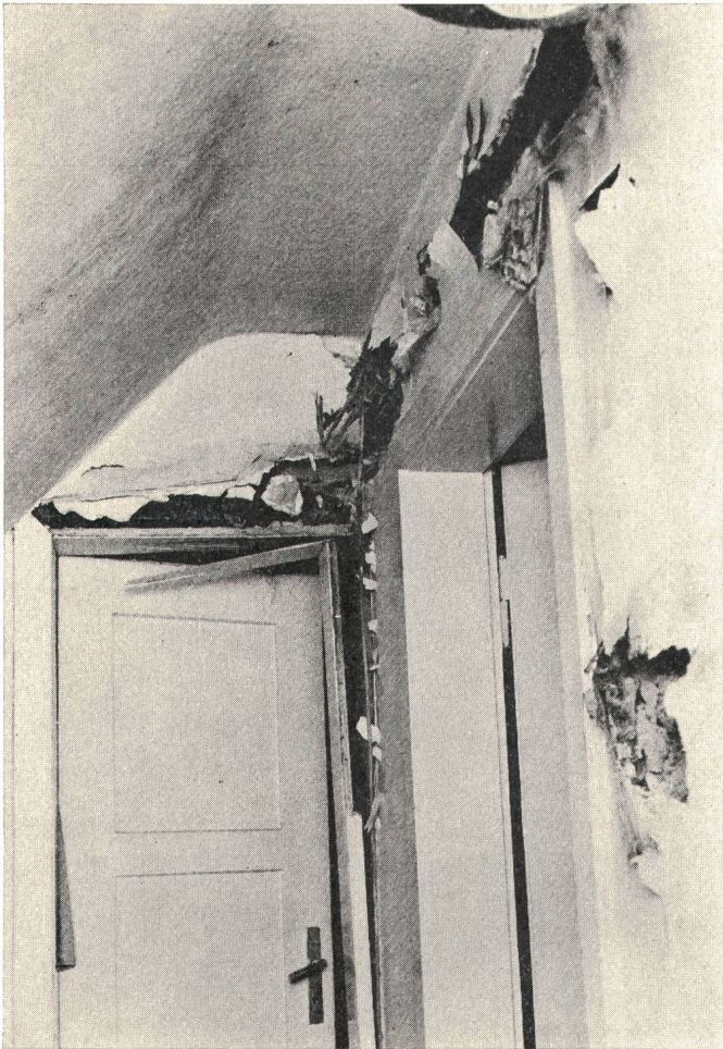
Fig. 9 Installationsleitungen wurden vom Blitzstrom verformt und aus der Wand gerissen (Zu dünne Drähte können verdampfen)
