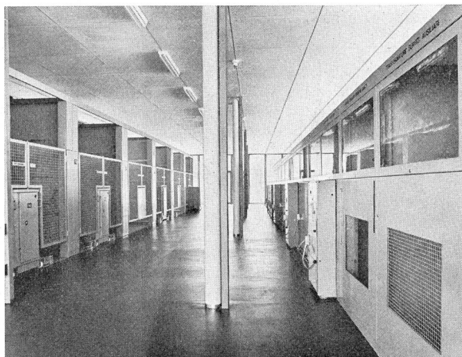
Fig. 8 L'intérieur de la sous-station 50/16 kV de Cadenazzo
