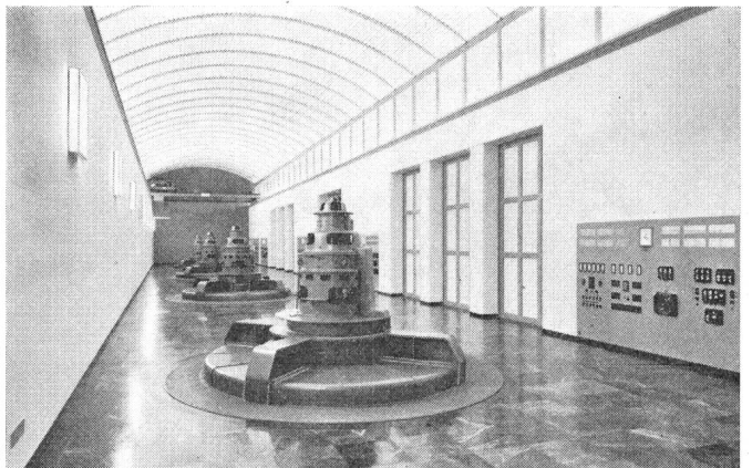
Fig. 4 Maschinensaal der Kraftwerkzentrale Verbano I
