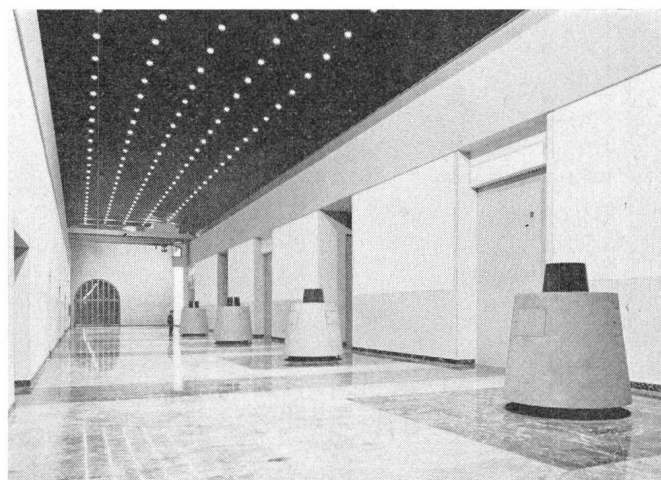
Fig. 8 Maschinensaal der Kraftwerkzentrale Robieci
