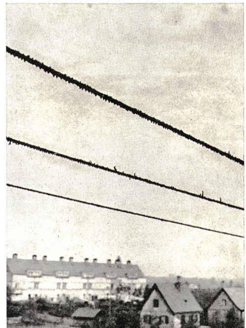
Fig. 8 Die drei Leiterseile einer früher mit 45 kV, jetzt jedoch mit 25 kV betriebenen Hochspannungs-Freileitung
