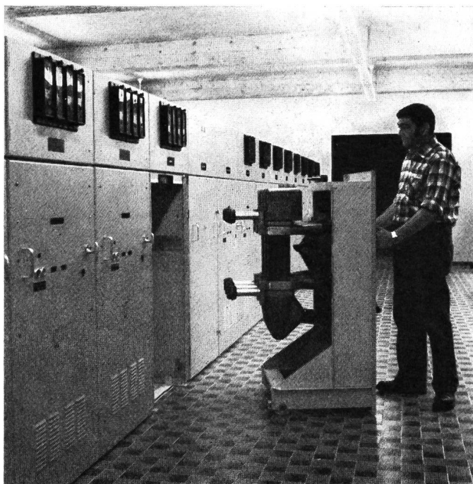
Fig. 4 Gekapselte Mittelspannungs-Schaltfelder mit ausgefahrenem ölarmem Schalter 12 kV, 1250 A, Abschaltvermögen 500 MVA
