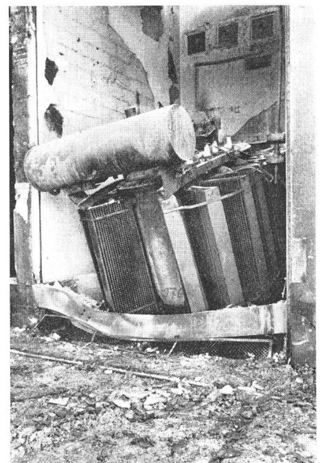
Fig. 2 Zerstörte Transformatorzelle im Unterwerk Aathal
