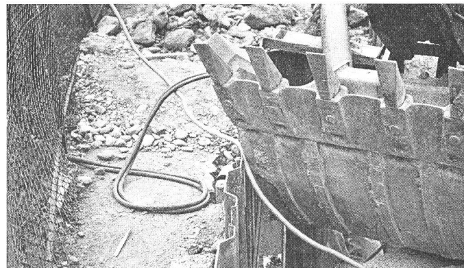
Fig. 9 Zuleitung einer Tauchpumpe, zwischen Spundwand und Baggerschaufel eingeklemmt und gequetscht
