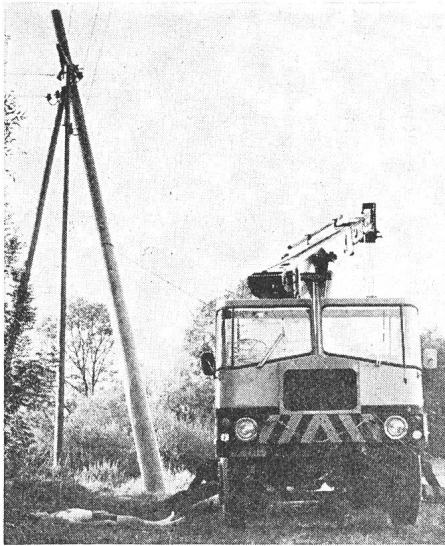
Fig. 3 Aufstellen eines Betonmastes mit Hilfe eines Kranfahrzeuges. Wegen ungenügender Verankerung geriet der Mast in die Freileitung. Beim Absteigen vom Fahrzeug wurde der Kranfahrer getötet
