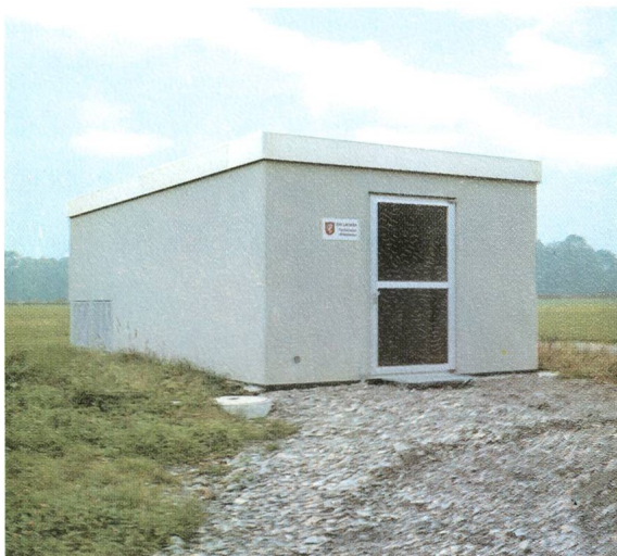
Überflur-Trafostation EW Lachen
