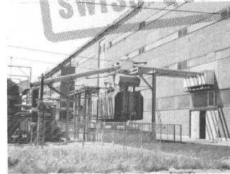
Generatorableitungen 21 kV, 13000 A
