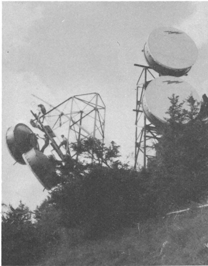
Fig. 5 Passivrelais der Richtfunkverbindung Innertkirchen-Grimsel
