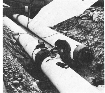
Fig. 5 Verlegung der Stahlmantelrohre Am offenen Rohrende (rechts) ist deutlich das innere Heizwasserrohr und darum herum die 10 cm starke Isolationssschicht zu sehen. Aussenhülle ist wieder ein Stahlrohr.
