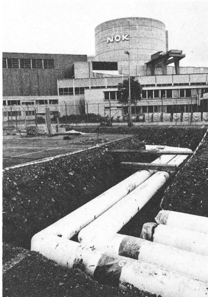
Fig. 4 Fernwärmeleitungen auf dem Inselareal Beznau Ab dem Maschinenhaus des KKW Beznau sind Stahlmantelleitungen in den Gräben verlegt.
