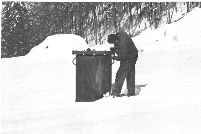
Fig. 1 Einer der acht Gasdome. Beim Auffüllen der Deponie kann er entsprechend hochgezogen werden
