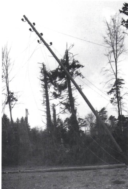
Fig. 3 Stromlieferung und Sender-Fernsteuerung durch Sturm unterbrochen
