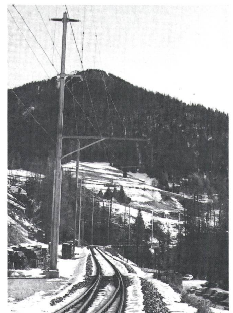
Figur 6 66-kV-Leitung in Bergün kombiniert mit der 11-kV-Fahrleitung
