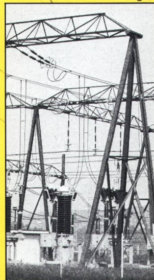
Korrosionsschutz an Schaltanlagen
