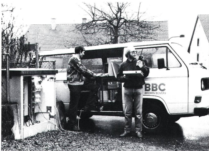
Figur 9 Messungen in einem 220-V-Netz. Fahrbare Messstation
