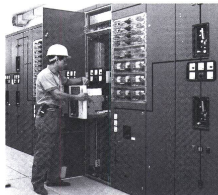
Figur 2 Ausfahren eines Leistungsschalters an einer wartungsfreundlichen Niederspannungsschaltanlage
