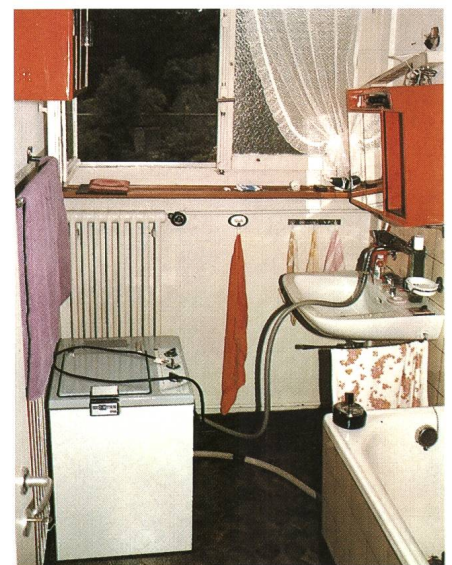
Figur 18 Durch Laien unsachgemäss installierte Steckdose an Toilettenschrank (rechts). Das Gehäuse der daran angeschlossenen Waschmaschine stand deshalb unter Spannung
