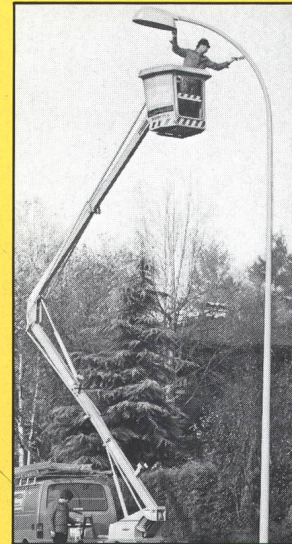
Korrosionsschutz an Stahlkandelabern
