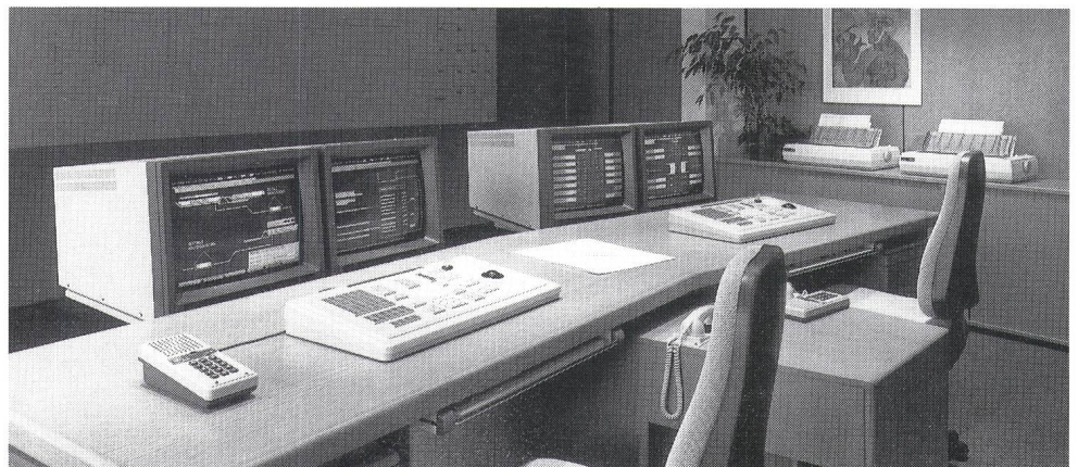
TELEGYR-Netzleitstelle des EWN Stans
