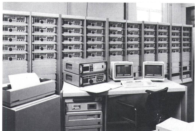
Bild 18 Empfängerbank mit 50 Empfängern von Telefunken Systemtechnik
