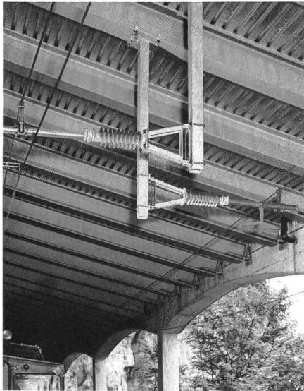
Bild 3 15-kV-Bahnisolator der Sefag AG im Lötschberg-Tunnel (BLS)
