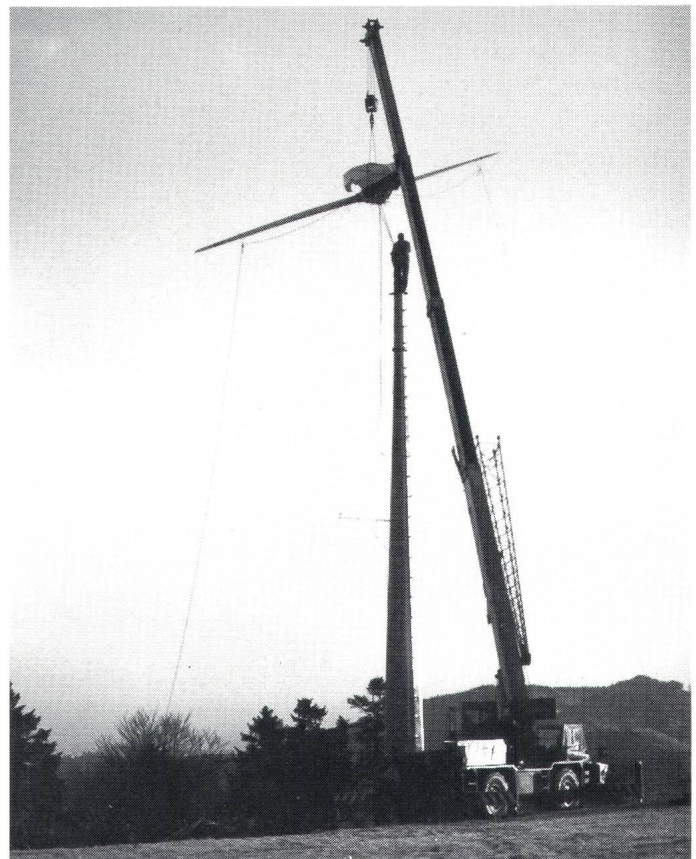
Bild 2 Montage der neuen Gondel auf den bestehenden Mast der Installation auf dem Sool
