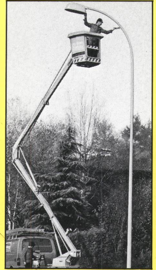
Korrosionsschutz an Stahlkandelabern
