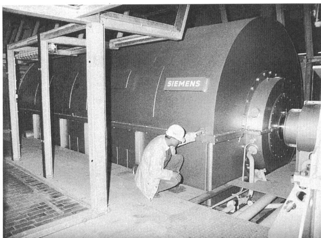
Luft statt Wasserstoff: Der grösste luftgekühlte Generator
