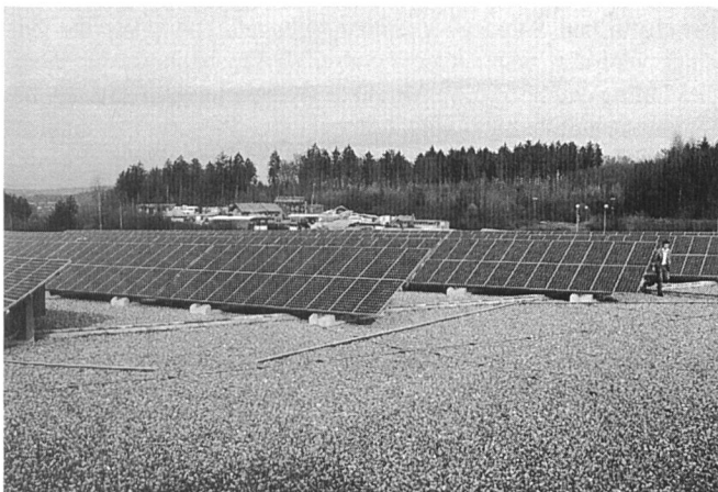
Die Kunden des Elektrizitätswerkes Bern können in Zukunft auf Wunsch Strom aus der Photovoltaikanlage in Bern-Neufeld beziehen
