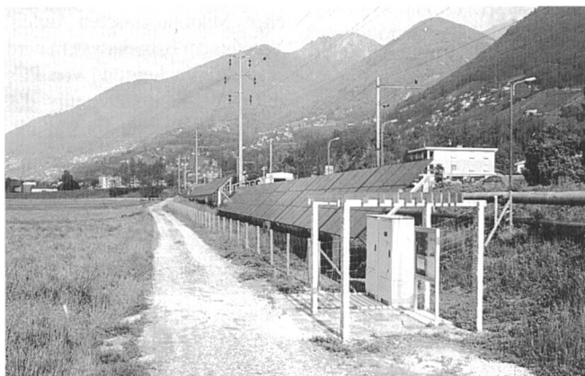
100-kW-Photovoltaik-Netzverbundanlage entlang der Bahnlinie Bellinzona-Locarno
