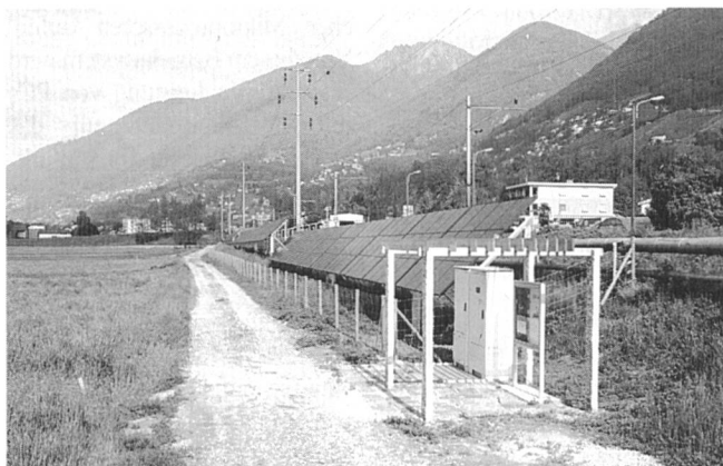
100-kW-Photovoltaik-Netzverbundanlage entlang der Bahnlinie Bellinzona-Locarno
