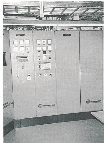
Bild 3 Schaltschrank des BHKW
