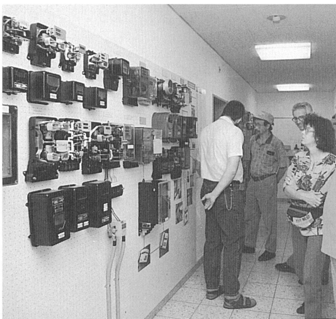
In einem der Gänge des Verwaltungsgebäudes war eine Schauwand mit Zählern und eine andere mit einer Rundsteuerung eingerichtet
